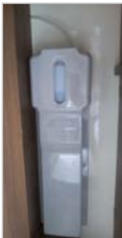
Εικ.6.41 - Επίπεδο μείγματος γλυκόλης
